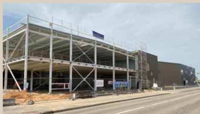
Le chantier d'extension du Super U a démarré le 22 mars et s'étendra sur une année.
