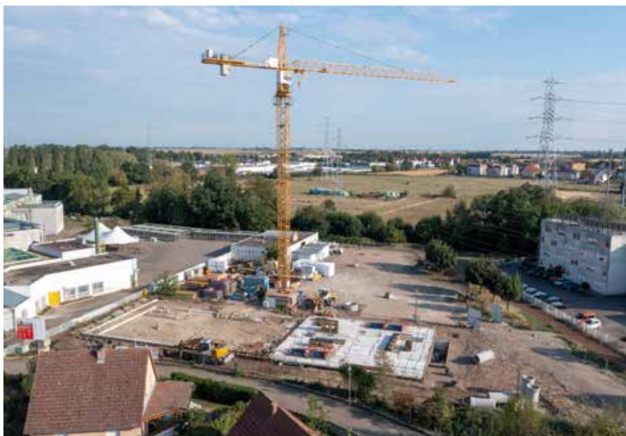
Les travaux de l'entreprise de gros œuvre Dicker située à Andlau se poursuivent et sous réserve d'aléas de chantier, le bâtiment devrait être hors d'eau et hors d'air d'ici la fin de l'année 2022.
