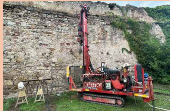
Plusieurs sondages ont été effectués cet été côté rue de l'Hôpital et côté avenue du Général-de-Gaulle pour évaluer la portance du sol et l'ancrage des fondations.
