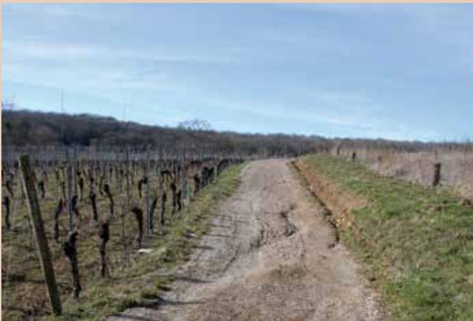
Trois dévers étaient recensés sur ce chemin. Les eaux pluviales entraînaient la formation de crevasses.
