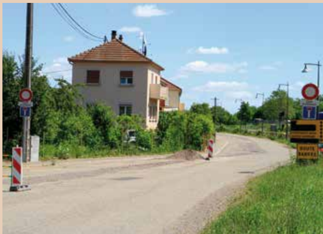
Pendant les travaux, la circulation était déviée vers le quai des Anciens Abattoirs mais l'accès aux riverains était maintenu.
