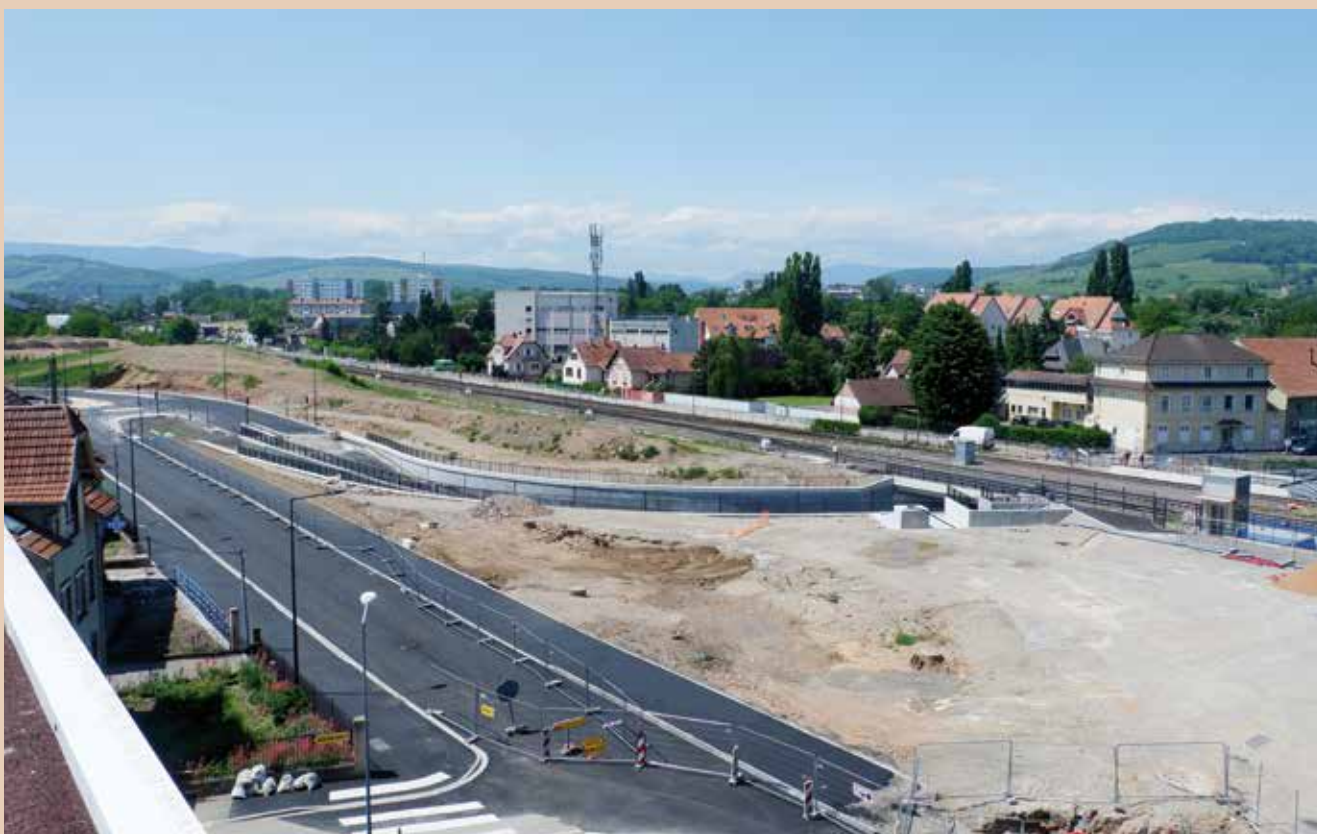
Grâce aux deux caméras positionnées côté Nord, ou comme ici côté Sud, on peut suivre l'évolution du chantier. Les premières couches d'enrobés ont été tirées et les mâts d'éclairage ont été remplacés (Photo Séquence Productions).
