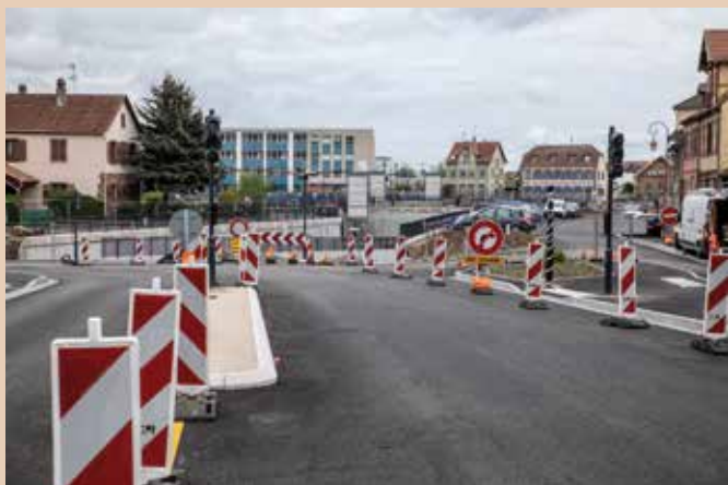
Côté tronçon de l'avenue de la Gare, il reste à tirer la dernière couche dite de roulement (Photos Passion Photo Club).
