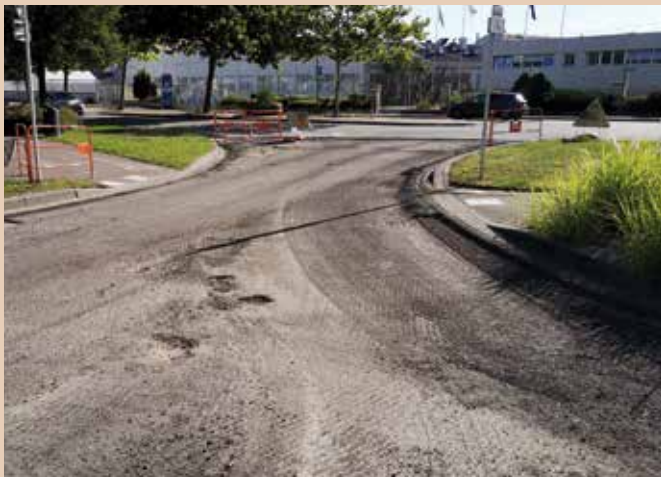
Un rabotage de la chaussée, sur 5 cm, a été effectué avant la pose d'un enrobé neuf.
